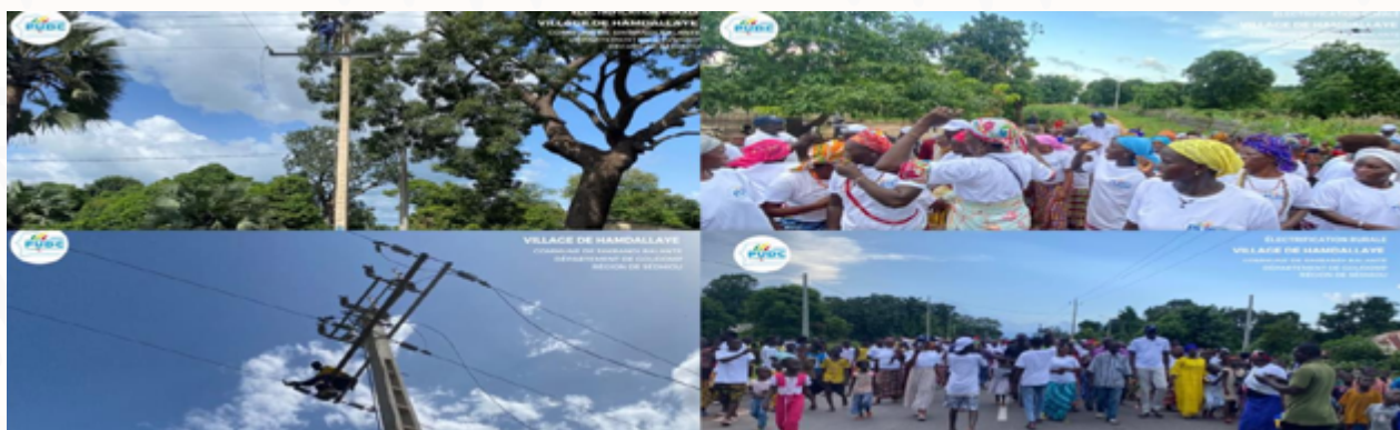
Projet d'électrification de 2000 villages : hamdalaye, commune de Simbandi Balante, département de Goudomp
